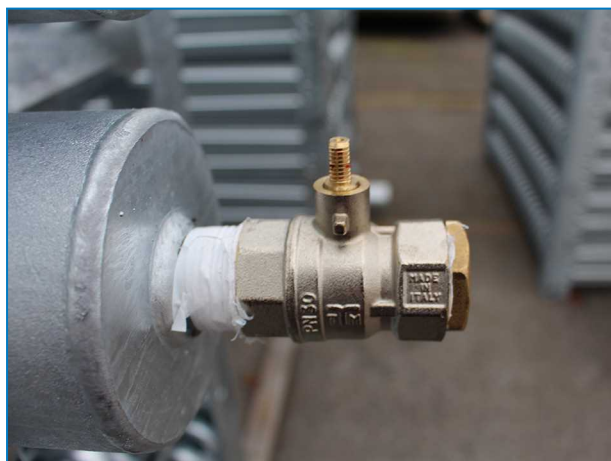
Horné spojenie výmenníka s uvoľňovacím ventilom tlaku na kondenzátory.
