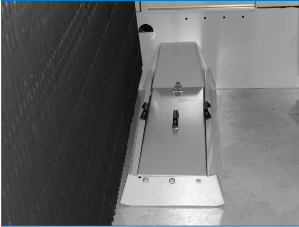
Kallvattenbassäng och bassängfilter
