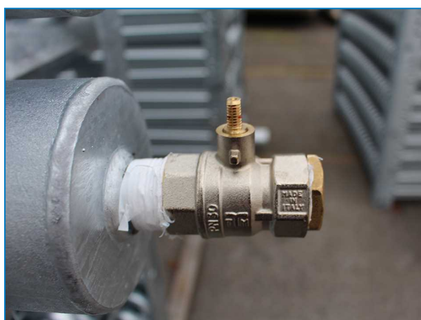
Górne złącze węzownicy z zaworem nadmiarowym na skraplaczach.
