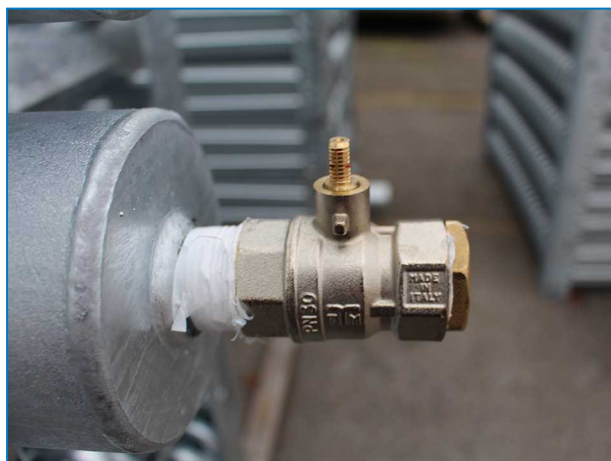
Górne złącze węzownicy z zaworem nadmiarowym na skraplaczach.
