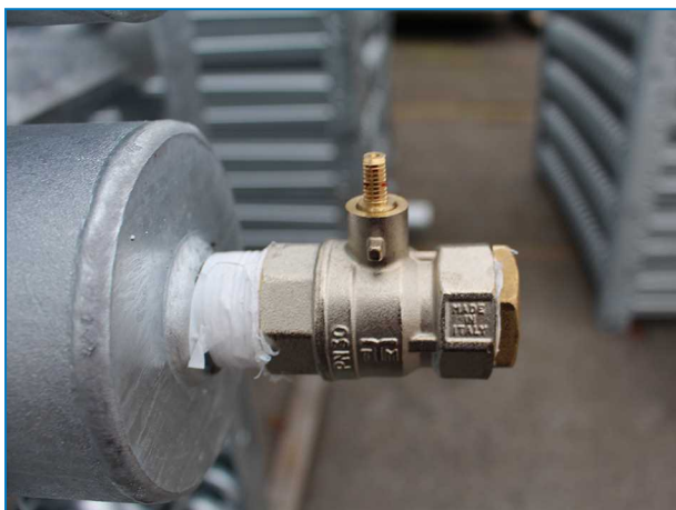
Bovenste batterijaansluiting met drukaflaatklep op condensers.
