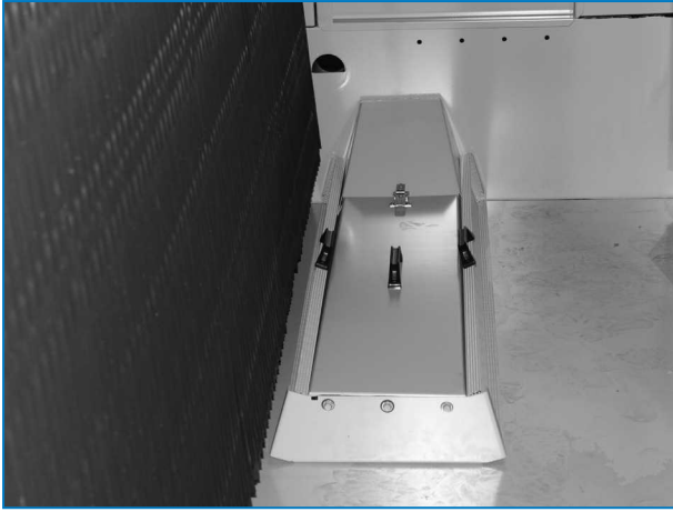
Koudwaterbekken en bekkenfilter
