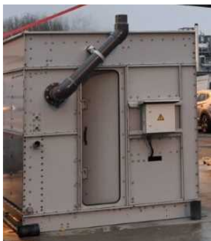
Rörledningar i botten
