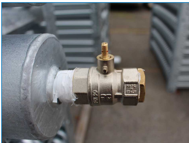
Övre slingkoppling med övertrycksventil på kondensorer.
