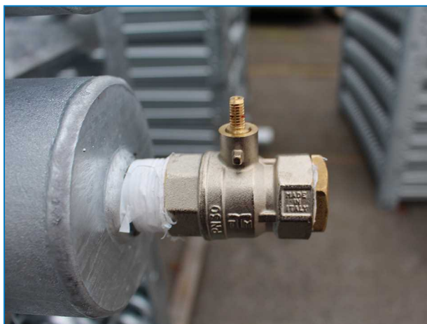
Ligação da serpentina superior com válvula de alívio de pressão nos condensadores.
