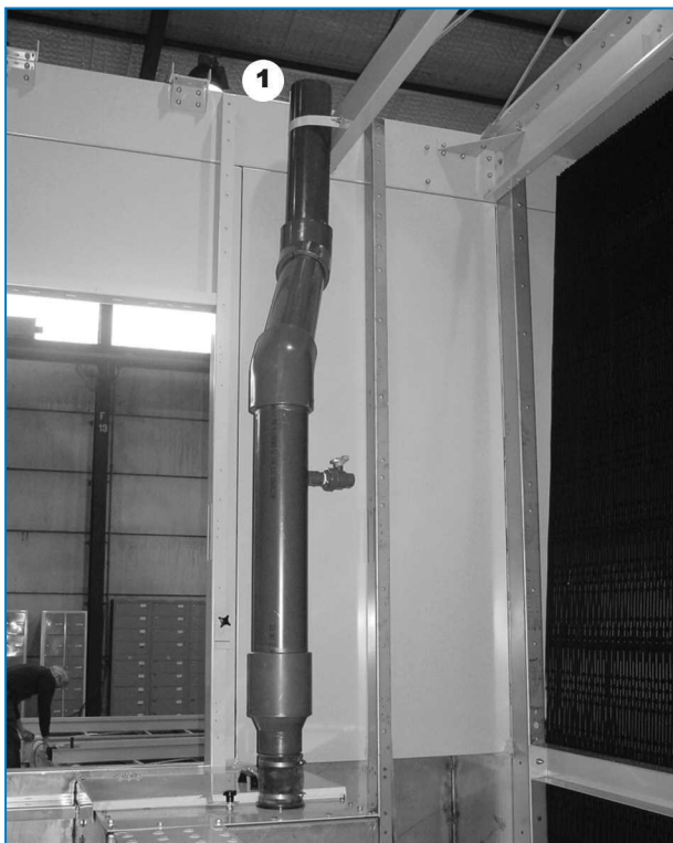
Tubature pompa sezione inferiore
