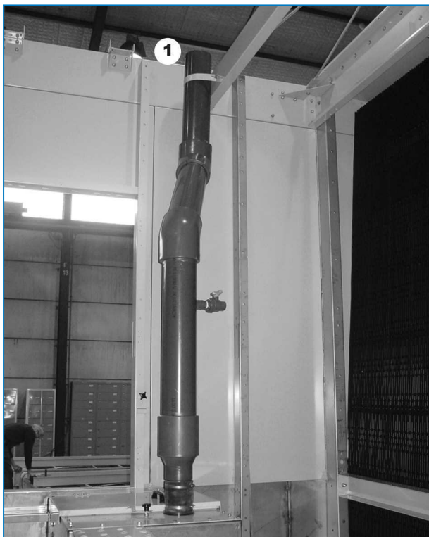
Tuyauterie de pompe section inférieure
