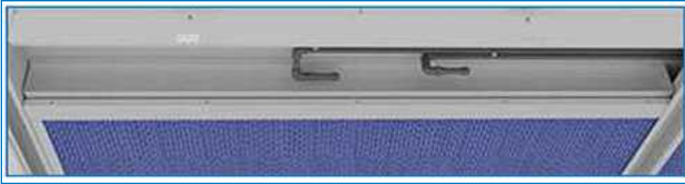
Distribución de agua del pre-enfriador
