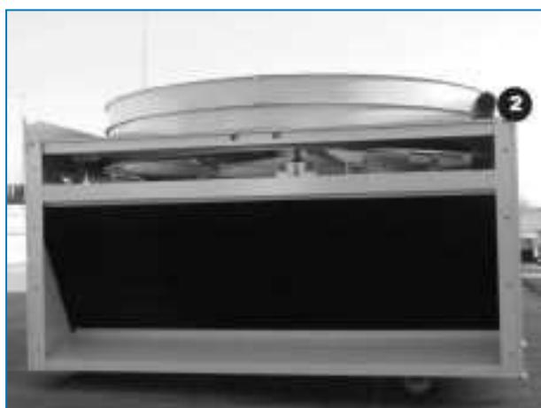
Připojení potrubí čerpadla ke komorové sekci z vnější strany
