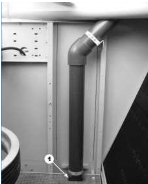
Potrubí čerpadla, komorová sekce uvnitř
