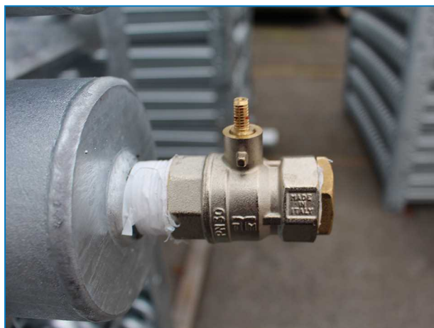
Horní připojení TVT s pojistným tlakovým ventilem na chladicích věžích s uzavřeným okruhem se spoji většími než ND100.
