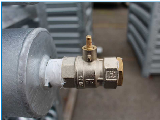
Conexión de batería superior con válvula de liberación de presión en condensadores.
