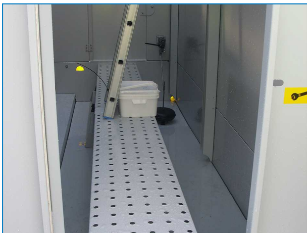
A szerelési anyagok elhelyezkedése belső kezelőjárdás berendezésnél
