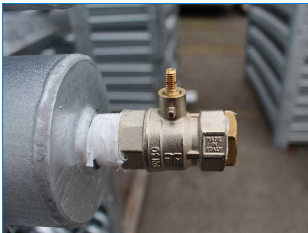
Oberer Rohrbündelanschluss mit Überdruckventil auf Verdunstungsverflüssigern.
