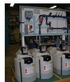
Urządzenia do uzdatniania wody
