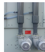
Rezerwowa pompa obiegowa
