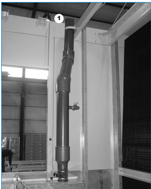
Трубопровод насоса в нижней секции
