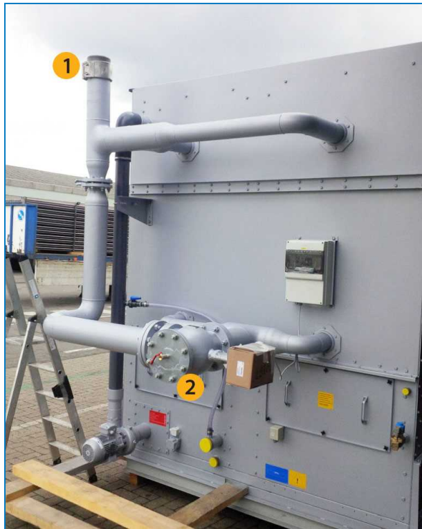
Блок с закрытыми наружными трубопроводами
